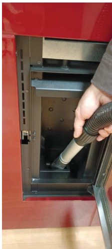
Fig. 44 - Limpieza alojamiento brasero
